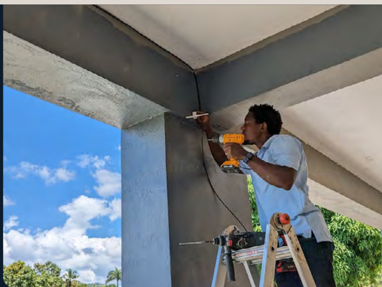
Le chapitre d'Haïti de l'Internet Society installe des équipements réseau pour connecter les communautés à travers l'île. © Chapitre d'Haïti de l'Internet Society
